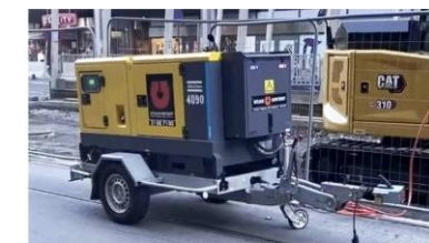
Dieselaggregatet lader en el-gravemaskin i Sternsgata i Oslo da den ikke kom seg til ladestasjonen. FOTO: PRIVAT
